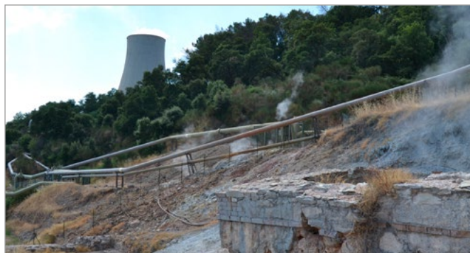
Instalaciones de la central próxima al parque geotérmico de Le Biancane, en Monterotondo Marittimo, al sur de Sasso Pisano. Foto: Jovita Ferrer.
