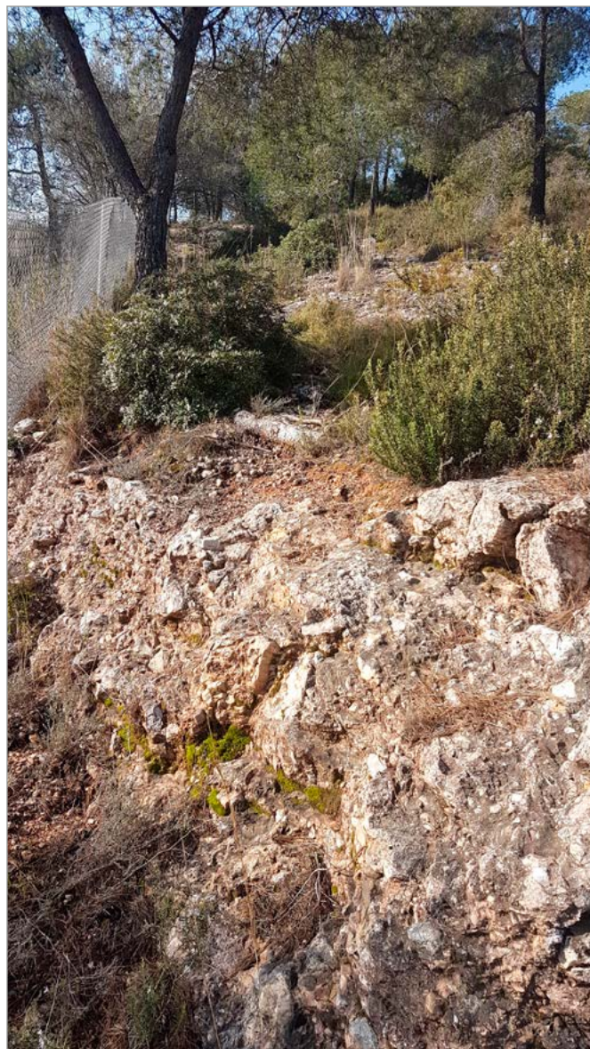
Figura 10. Zona superior del corte de la trinchera; a la izquierda se observa la valla de la autopista (febrero 2020). Foto: Frederic Varela.
